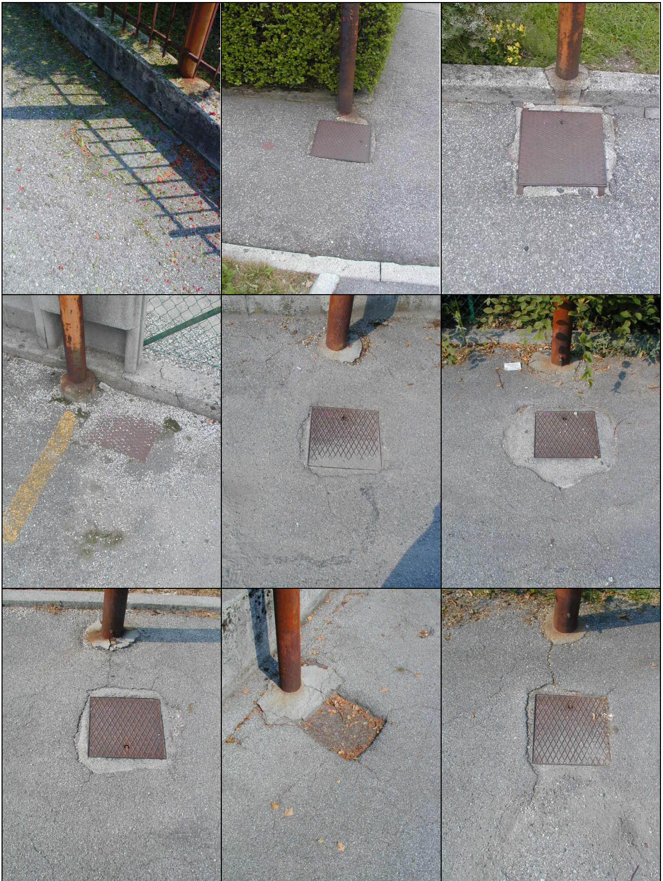
Figura 1.30 – Carrellata di basi dei sostegni che devono essere adeguati o completamente sostituiti
